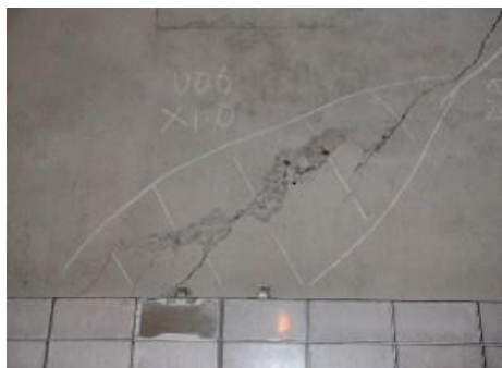
<高原トンネル内クラック状況>
